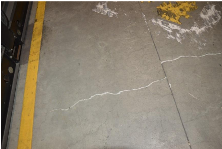
Rys. 5. Rysy naprawione przez uszczelnienie.
