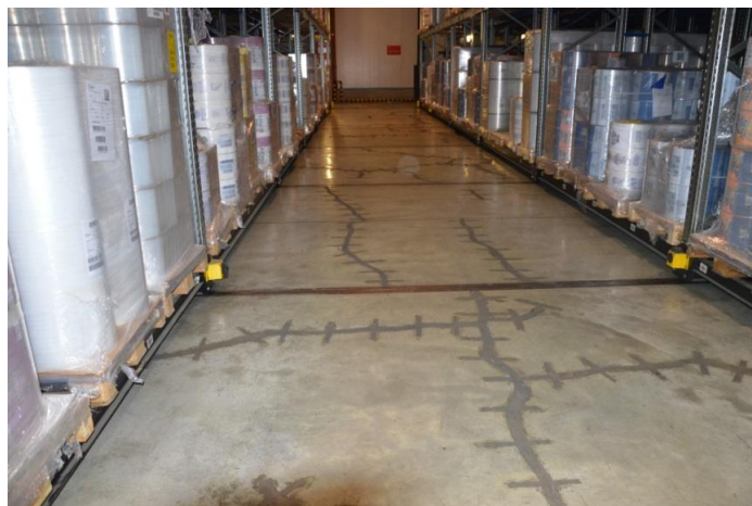
Rys. 3. Widok zarysowania posadzki na szerokości hali.
